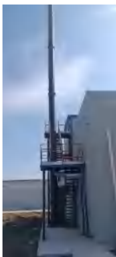
蒸汽发生器和导热油炉废气处理装置
