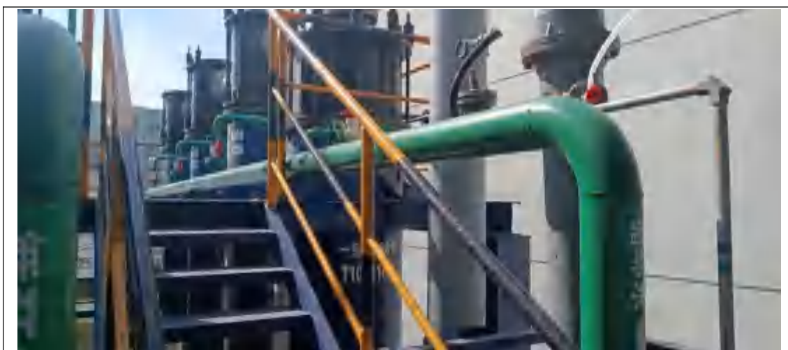
五氯吡啶生产装置废气处理装置
