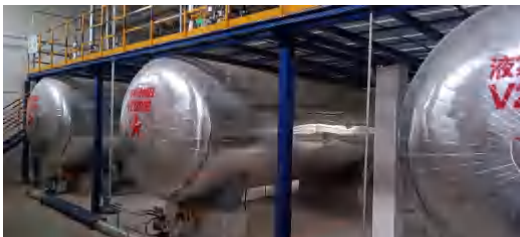
液氯罐区应急处置系统
