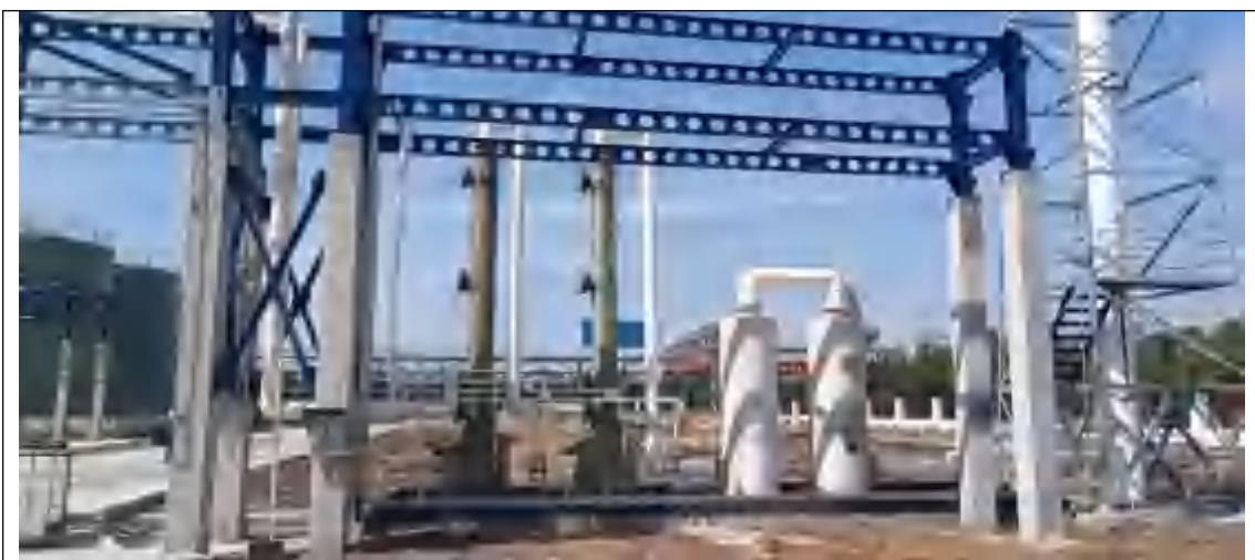
罐区废气处理装置
